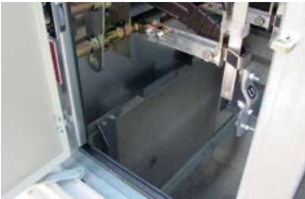
Abb. 15 Kantenschutz und entgradete Oberflächen
